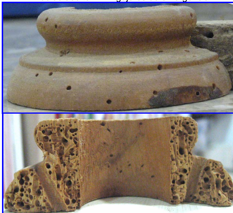
Aspecto superficial y estado interno de la madera
