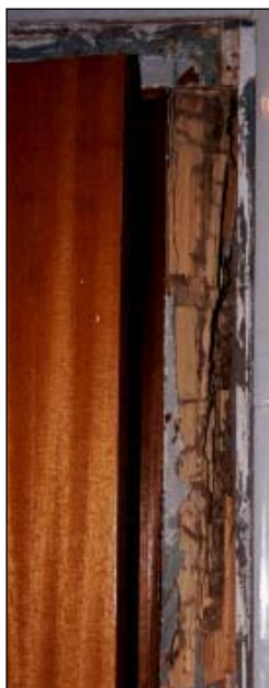
Figura 1. Daños producidos por las termitas en un marco de puerta, sus destrozos se manifiestan por la acción prolongada de las termitas.
