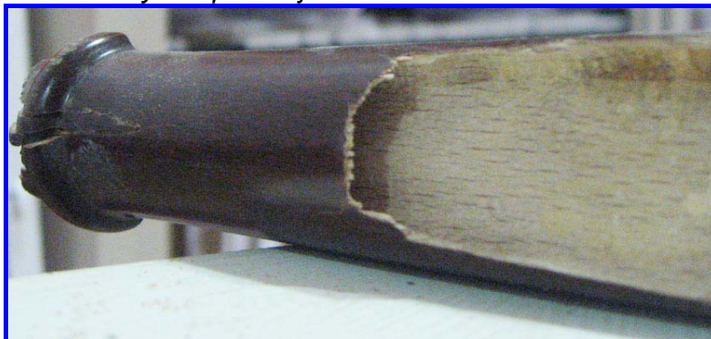
Las galerías se confunden erróneamente con las de termitas
